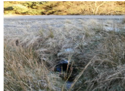
300Ø HDPE pipe inlet
